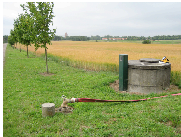
Risiko for forureninger via markvandsboringer, hvor der ikke er monteret kontra ventil til sikring af tilbageløb
